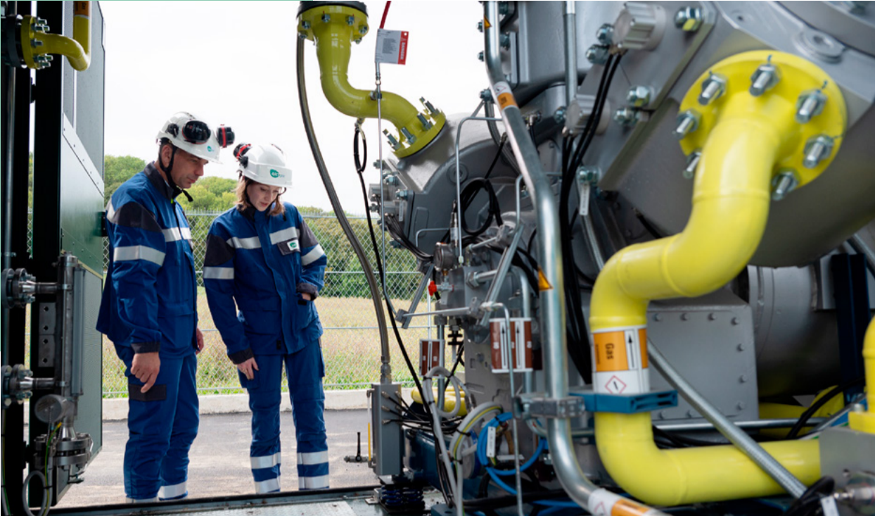
Deux opérateurs GRTgaz contrôlent le poste de rebours de Marchémoret (Seine-et-Marne).
