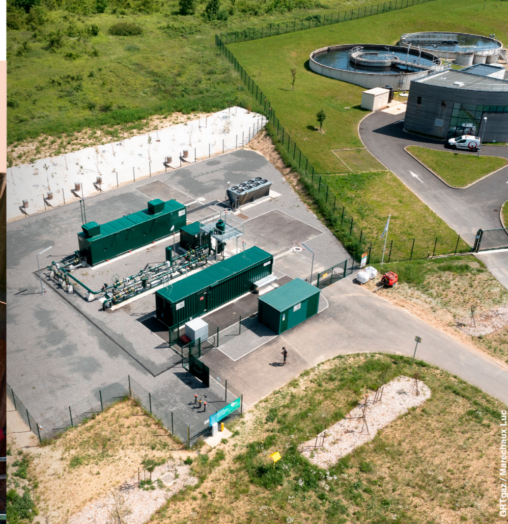
Installation de rebours de Mareuil-lès-Meaux (77)
